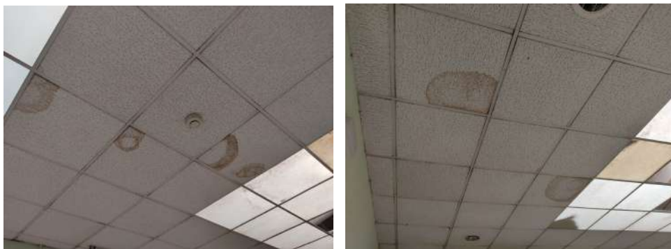
Taques d'humitats de filtració en el cel ras de la zona de l'escala interior
